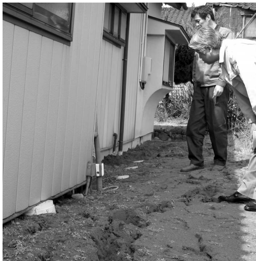
議会による被災調査（大崎地内）
