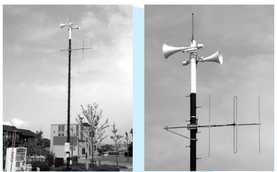
同報系防災行政無線 (内灘町)
