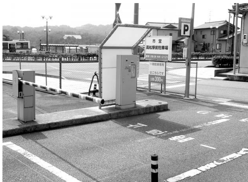
老朽化したカーゲートシステム（高松駅前）
