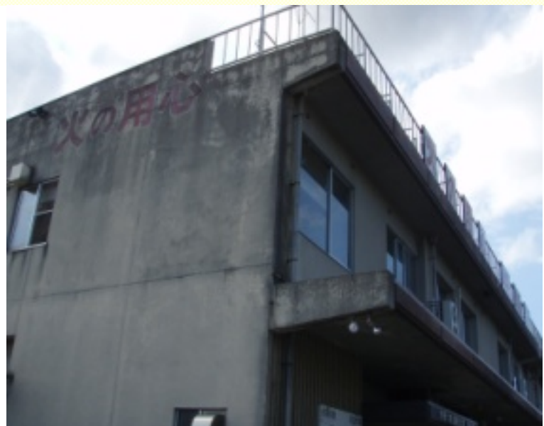
外壁の改修が待たれる消防庁舎！
