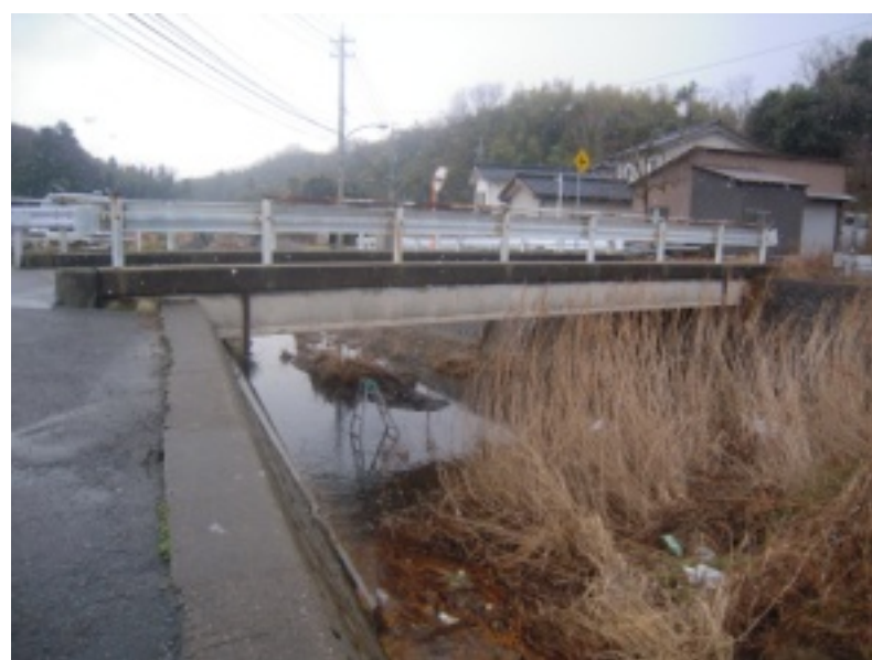
工事が待たれる大谷橋
