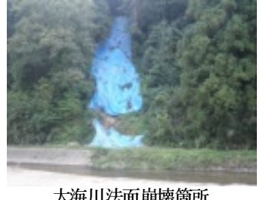
大海川法面崩壊箇所
