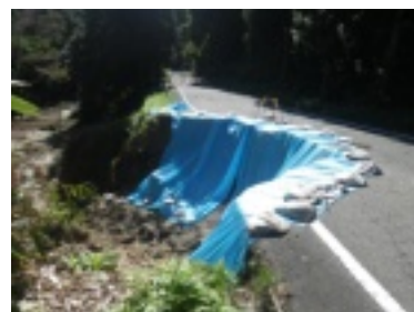
豪雨被災箇所
