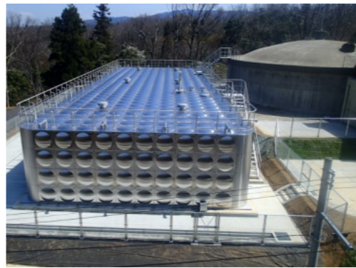
水道施設（高松高区配水地）
